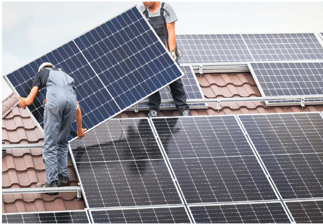
Wer sich eine Photovoltaik aufs Dach setzen lässt, tut viel für den Klimaschutz. Doch rechnen muss er nicht nur mit den Installations- und Amortisationskosten, sondern auch mit einer höheren Steuerrechnung. BILD SHUTTERSTOCK
